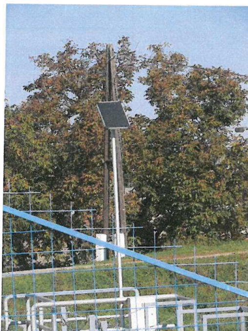
Oszlopon elhelyezett napelem a szivattyútelep mellett
